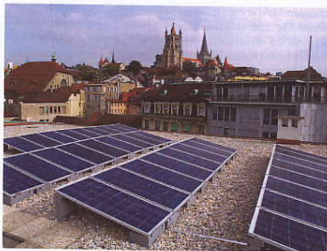
PANNEAUX SOLAIRES Installés sur le toit de la Régie Braun, à Lausanne.
